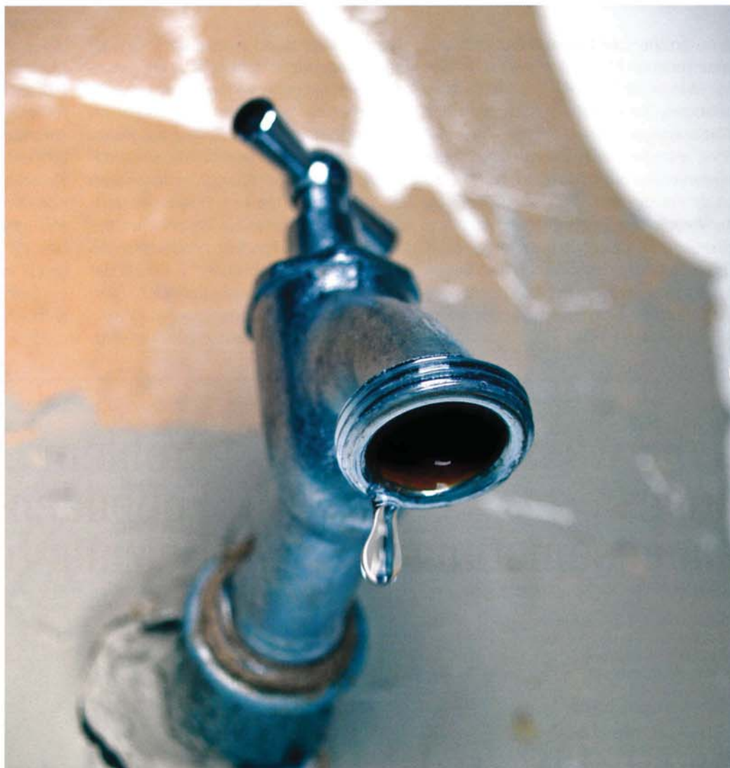
Die Hausinstallation für Trinkwasser hält für Eigentümer und Verwalter einige Haftungsrisiken bereit.
